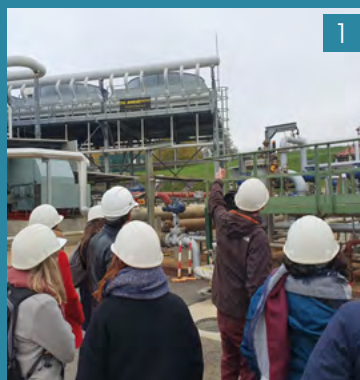
Photo > [1] Visite de la centrale de Rittershoffen © Eost
